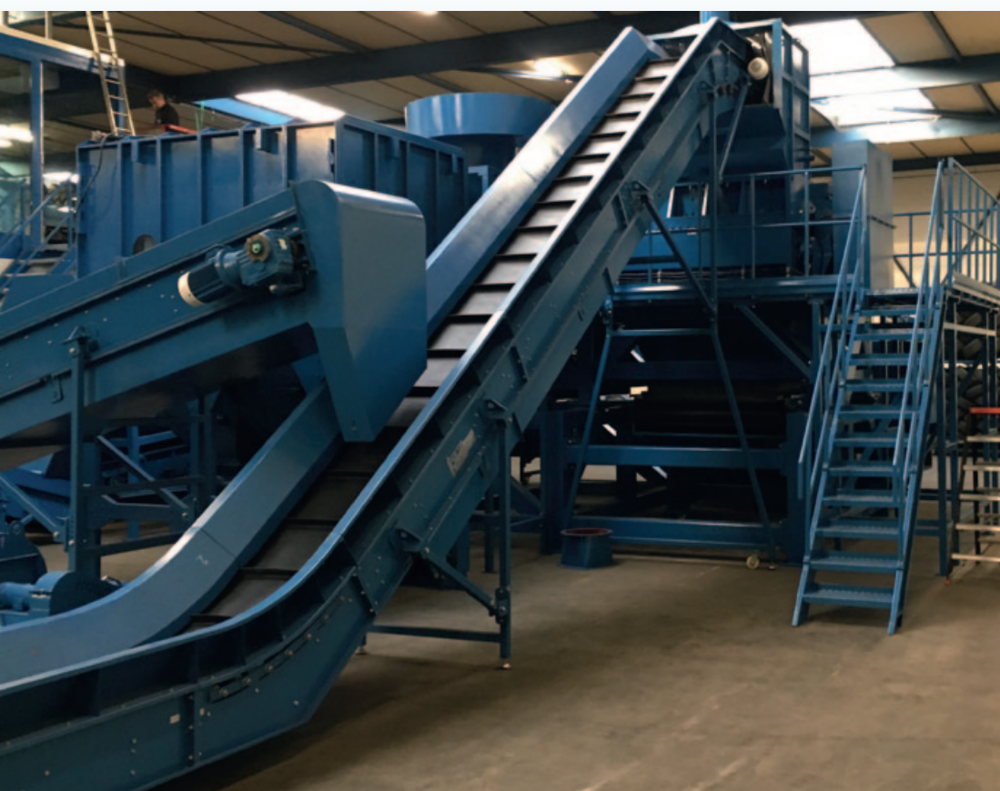
De onlangs bij een klant geplaatste bandenrecyclinginstallatie
